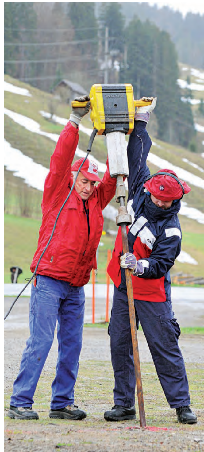
Nützliches Hilfsmittel: Mit vereinter Kraft und einem Kompressor werden die riesigen Erdanker in den Boden getrieben.
