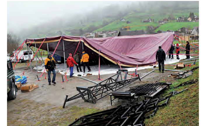
Das Zelt nimmt Formen an: Die insgesamt 31 Rondellstangen stehen schon fast alle. Noch nicht gesetzt sind die Masten.
