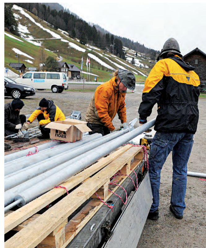
Die Eisen sind nass und kalt: 31 Rondellstangen braucht das neue Zelt des Zeltainers.
